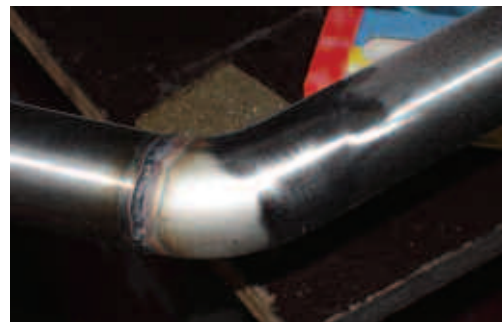
Ausencia de ángulo interior cerrado.
