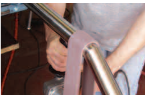
Operación de acabado con una herramienta portátil de fácil uso. El ángulo cerrado de la unión es aún visible con la soldadura completamente igualada.
